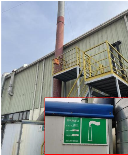
废气排气筒（DA001）
