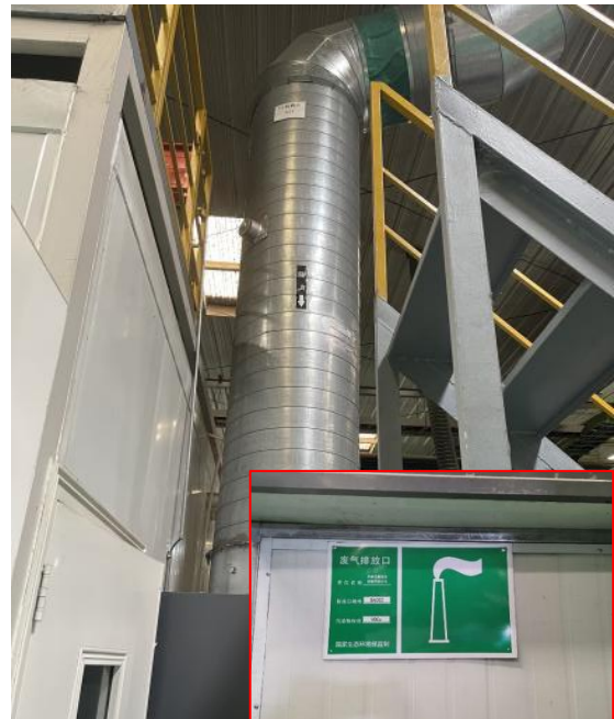
废气排气筒（DA002）
