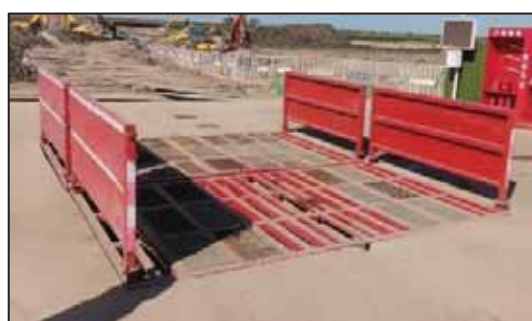
车辆冲洗设施
