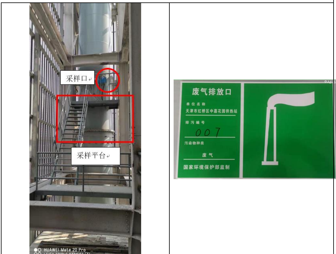
排气筒 DA001 30m
