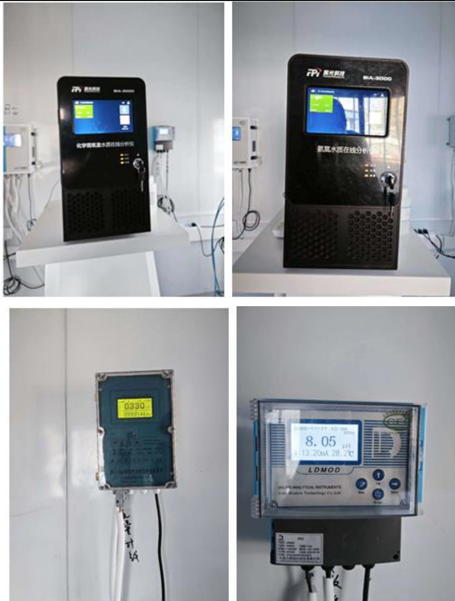
一分厂南侧厂区废水排放口 DW002
