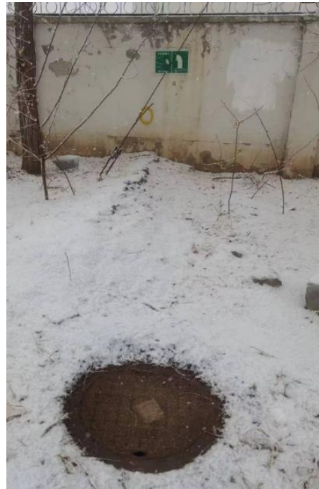
污水排放口标识牌
