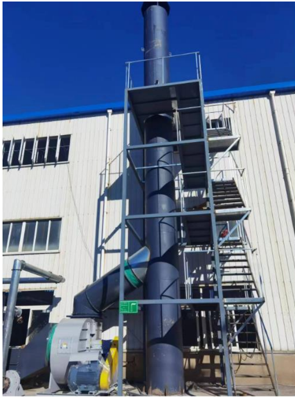
排气筒 DA001 及采样平台
