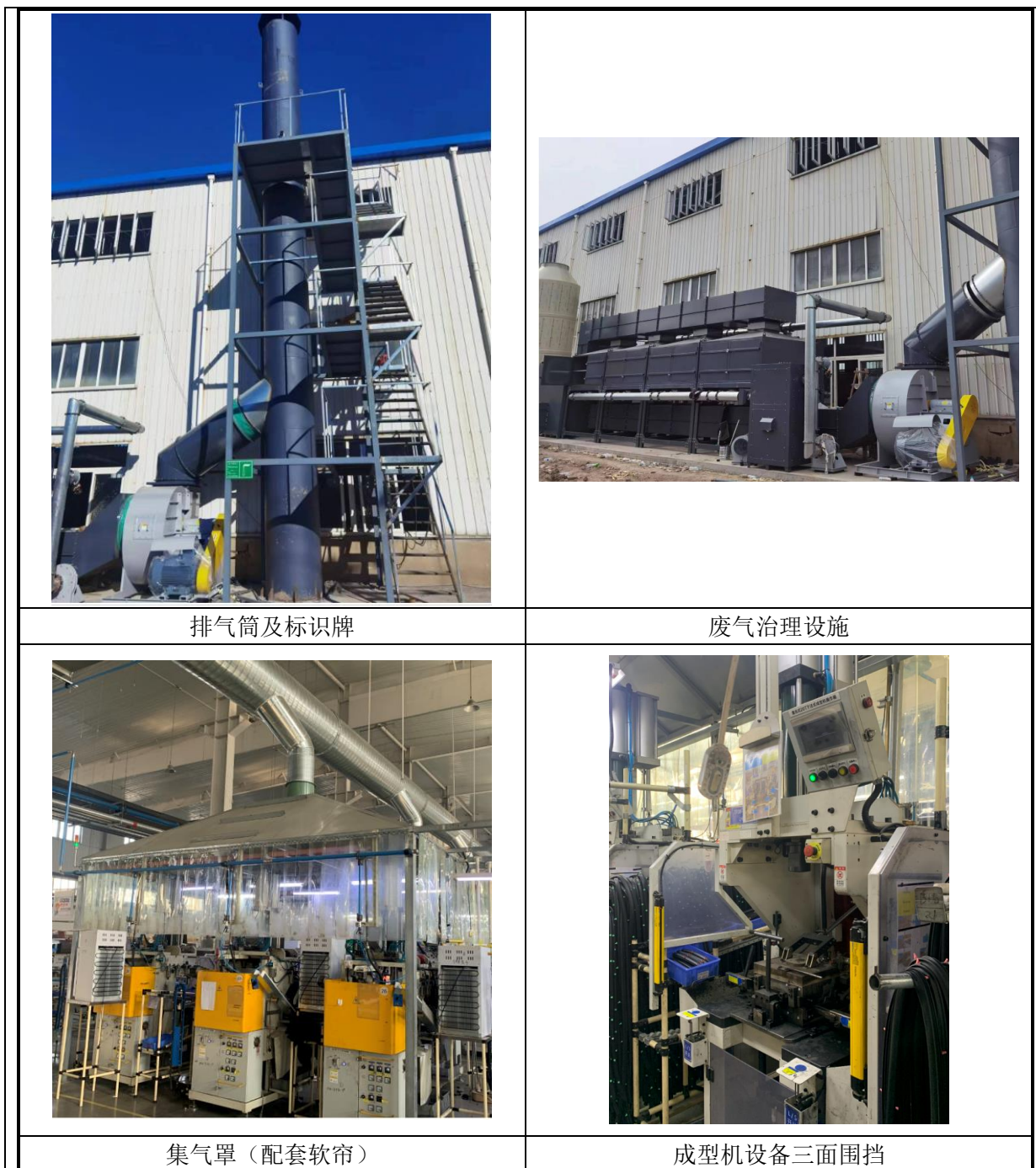
图 3-1 废气处理设施实际建设情况图
