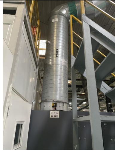
废气排气筒 (DA002)
