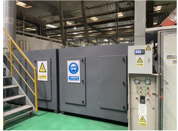
废气治理设施 (TA002)
