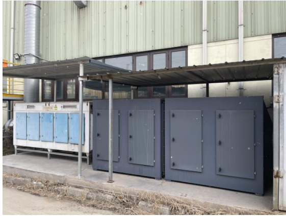
废气治理设施 (TA001)
