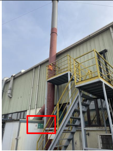
废气排气筒 (DA001)
